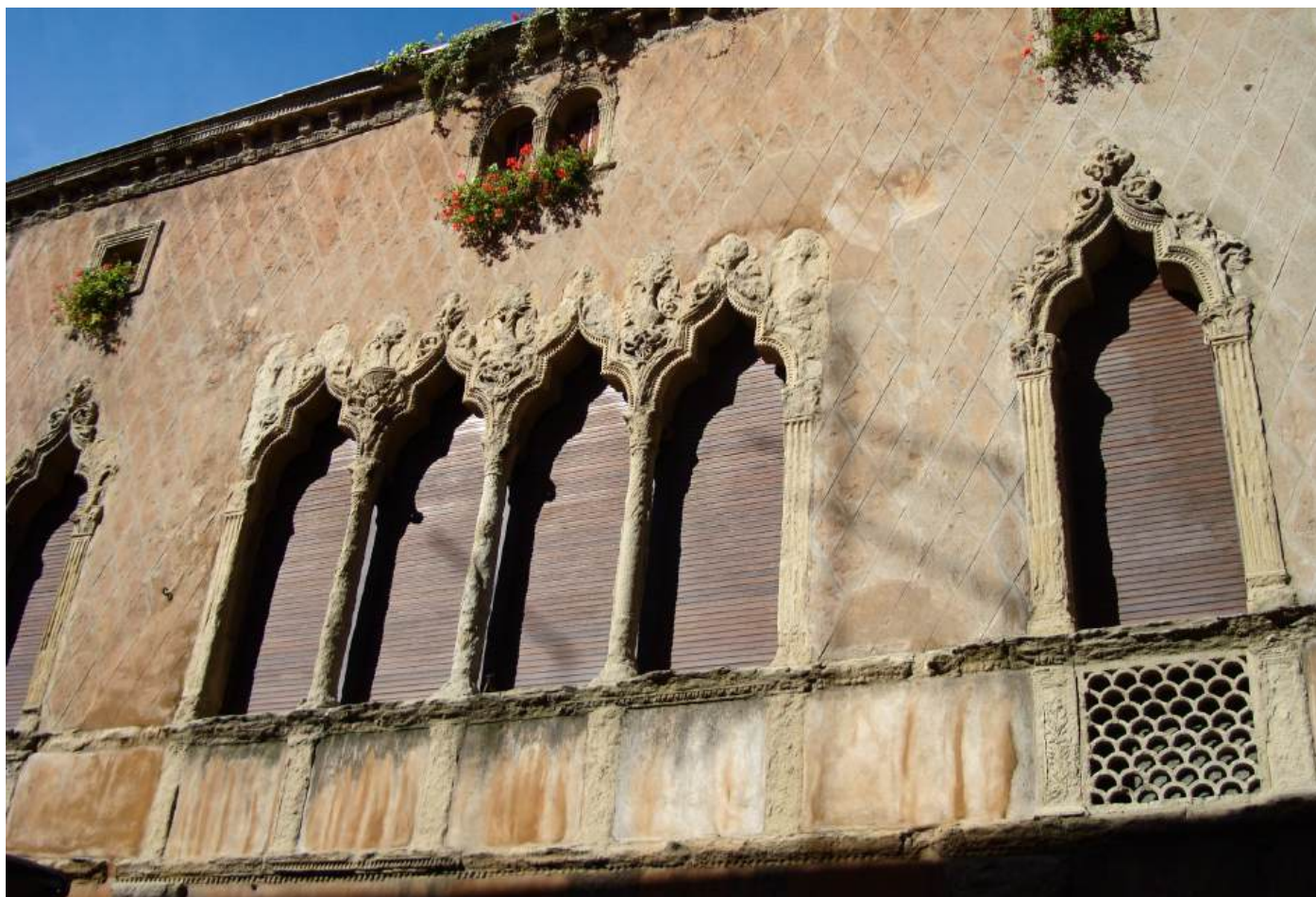
Quadrifora in stile gotico veneziano di Casa Olzignani, in via Umberto I a Padova. Sono evidenti i danni causati dagli agenti atmosferici.
